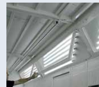
Plafoniere ad angolo incernierate per facilitare la pulizia e la manutenzione. Hinged light fixtures for ease of cleaning and maintenance.
